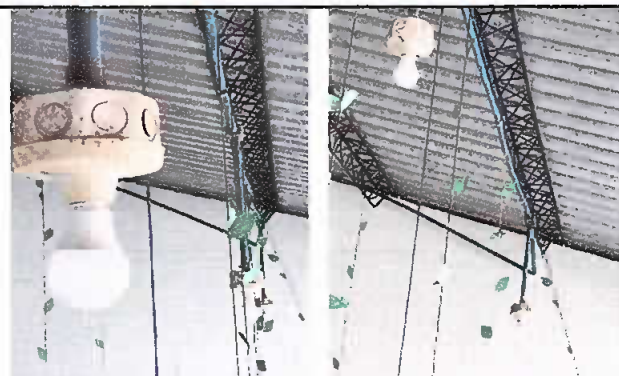
Módulo 1: Sustitución de lamparas tipo LED
